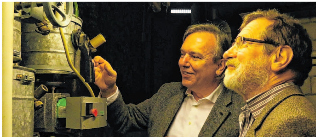
Manfred Gaupp (rechts) und Matthias Kühn vom Umweltteam der Kirchengemeinde im Heizungsraum der Schlosskirche. Früher gab es 20 Grad bei den Gottesdiensten, heute sind es 16 Grad. Dadurch kann nicht nur viel Geld gespart werden. Auch die Umweltbelastung wird reduziert.
